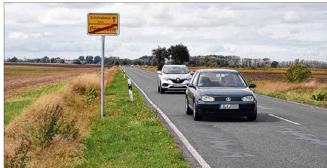
Die Sanierung der Landesstraße 51 wurde zum wiederholten Mal verschoben. Nun soll der Abschnitt Schönebeck-Pömmelte im ersten Quartal 2021 ausgeschrieben werden. Foto: Thomas Linßner
